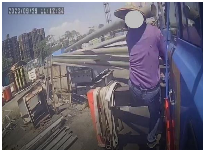
▲吊掛用之纖維索斷裂，吊掛物飛落
