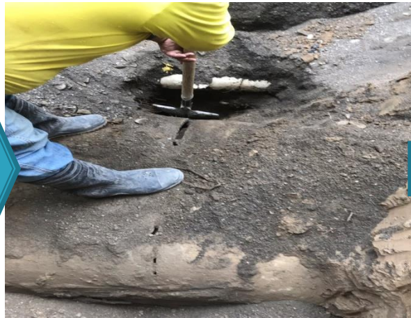
涵管接合處脫管
