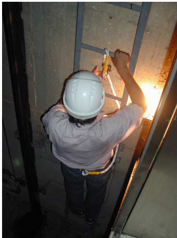
照片3 升降路與機坑內的臨時照明應使用安全電壓
